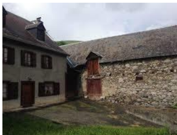
Toiture sans gouttière
